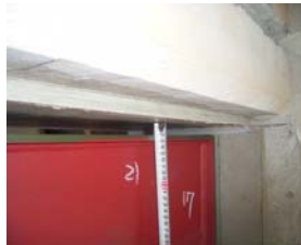
躯体と鉄骨との隙間
