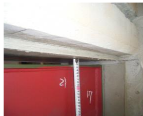
躯体と鉄骨との隙間
