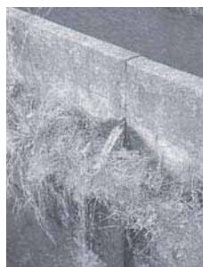
漏水状況の事例*
