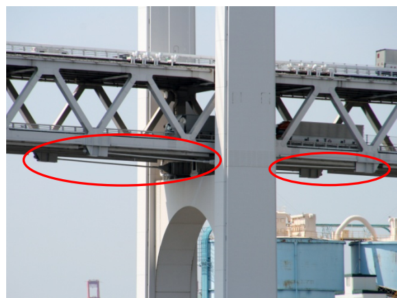
写真－3 塔部変位制御装置
